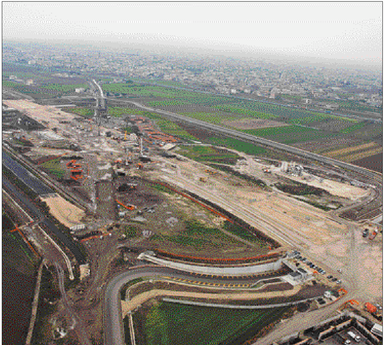
Il cantiere della stazione dell'Alta velocità di Napoli Afragola (progetto di Zaha Hadid Architects)
