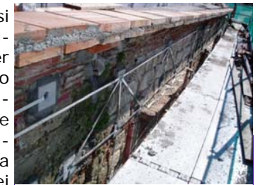
Cordolo tipo GIUFFRÈ, senza necessità di demolire la muratura e la copertura, realizzato con due correnti parallele e collegamenti diagonali.
